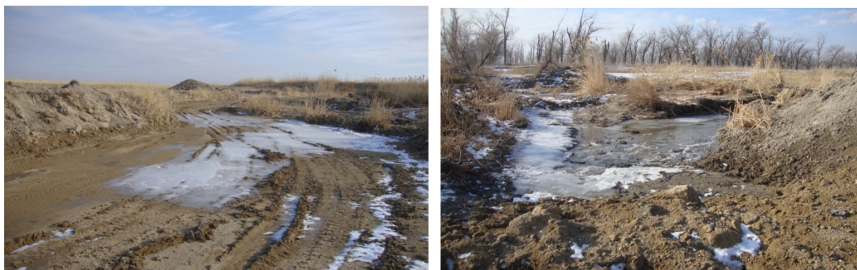
Рисунок 1 - ВХК «Сейдалы» на поверхность выступают грунтовые воды
