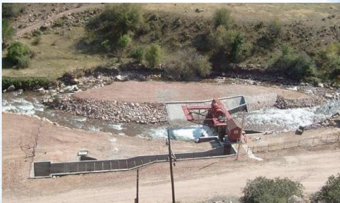
Рисунок 3 - Водозаборное сооружение для деривационной ГЭС, построенное в 2010 г. на реке Мерке в Меркенском районе, Джамбульской области, Казахстан.
