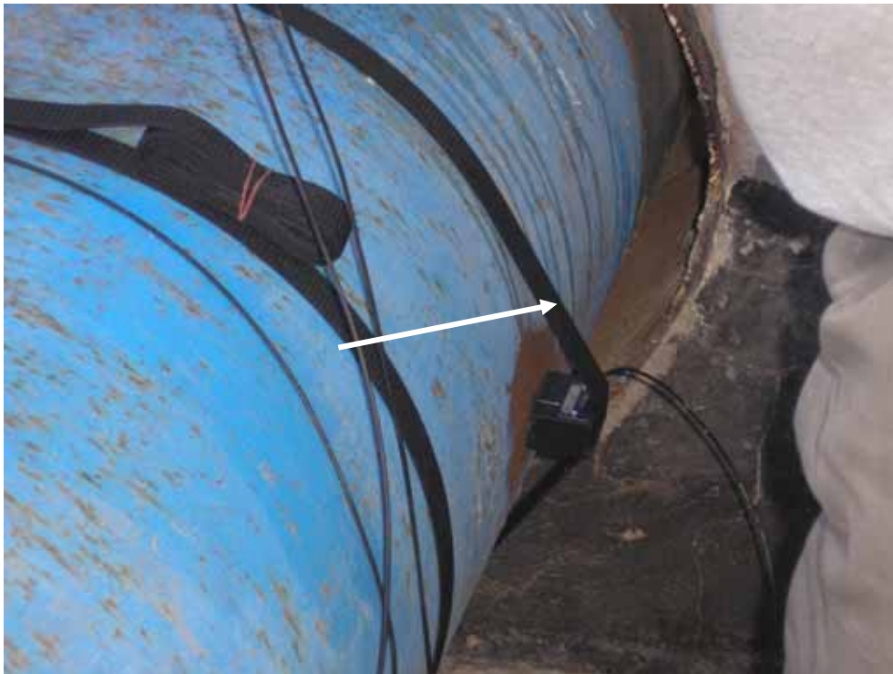
Ультразвуковые датчики установленные на поверхности напорного трубопровода
