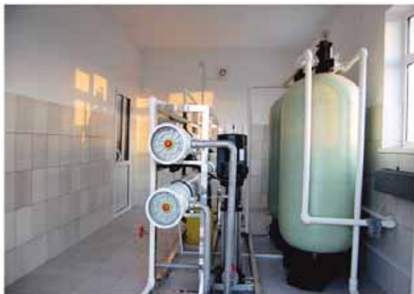
Опреснительная установка и фильтр
