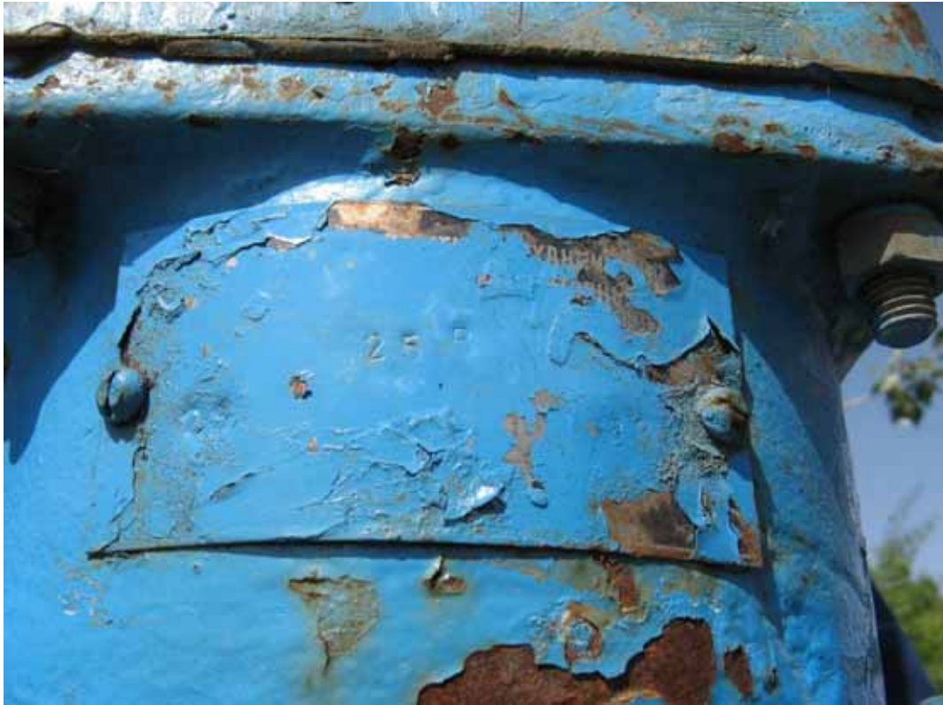
Редуктор в плохом состоянии в точке б
