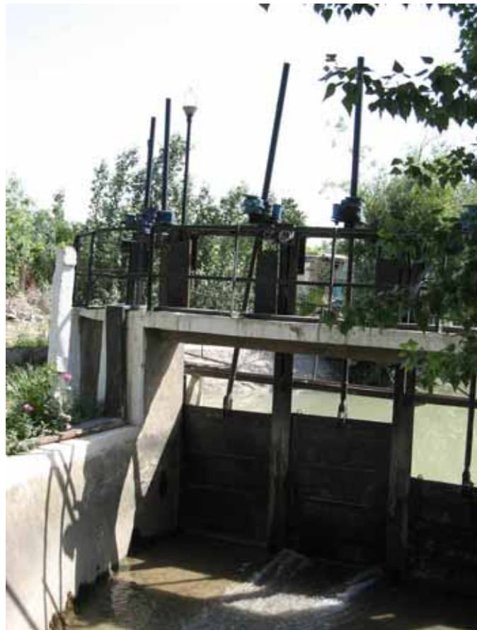
Поврежденная опора редуктора в точке б
