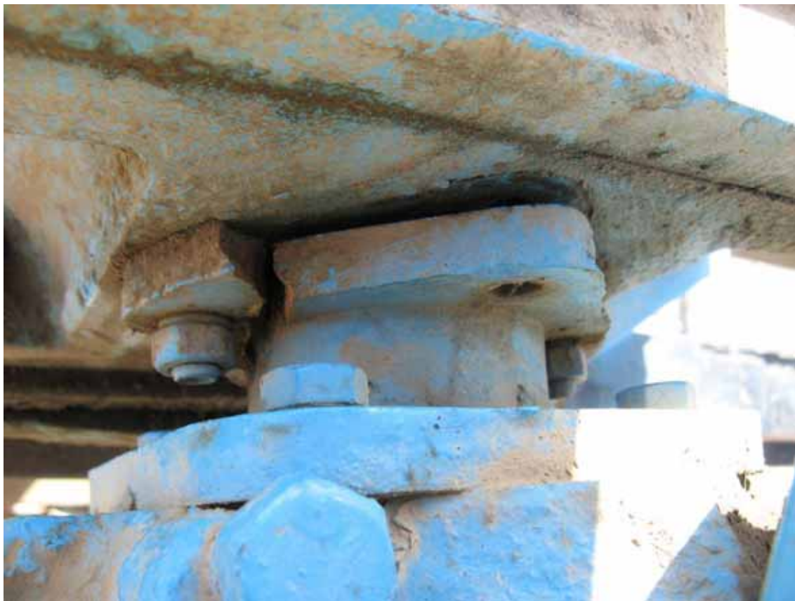
Поврежденный корпус редуктора в точке 3
