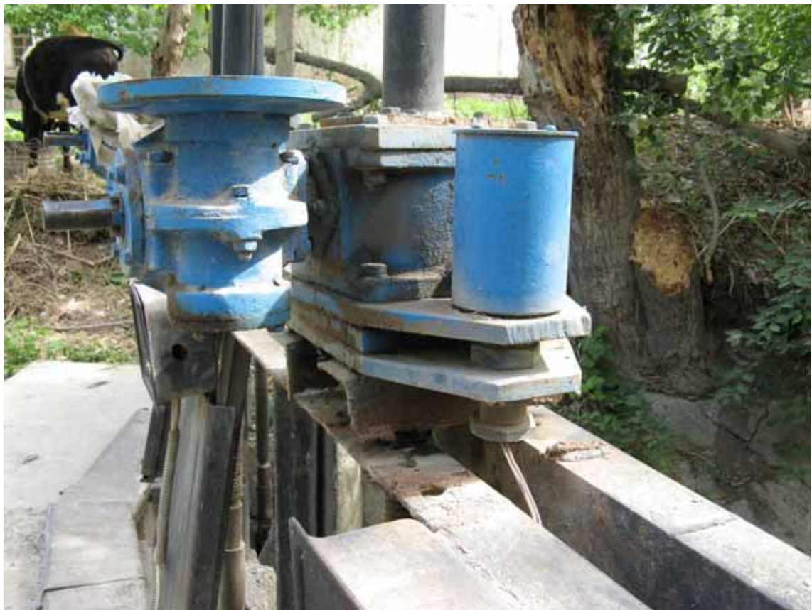
Поврежденная опора редуктора в точке б
