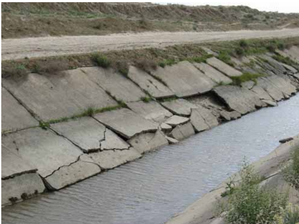
Поврежденная облицовка канала в точке 4
