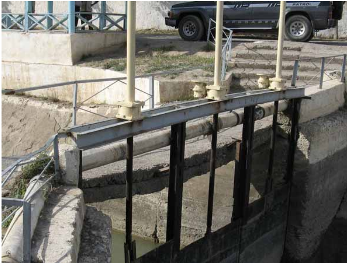
Отсутствуют редукторы в точке 5
