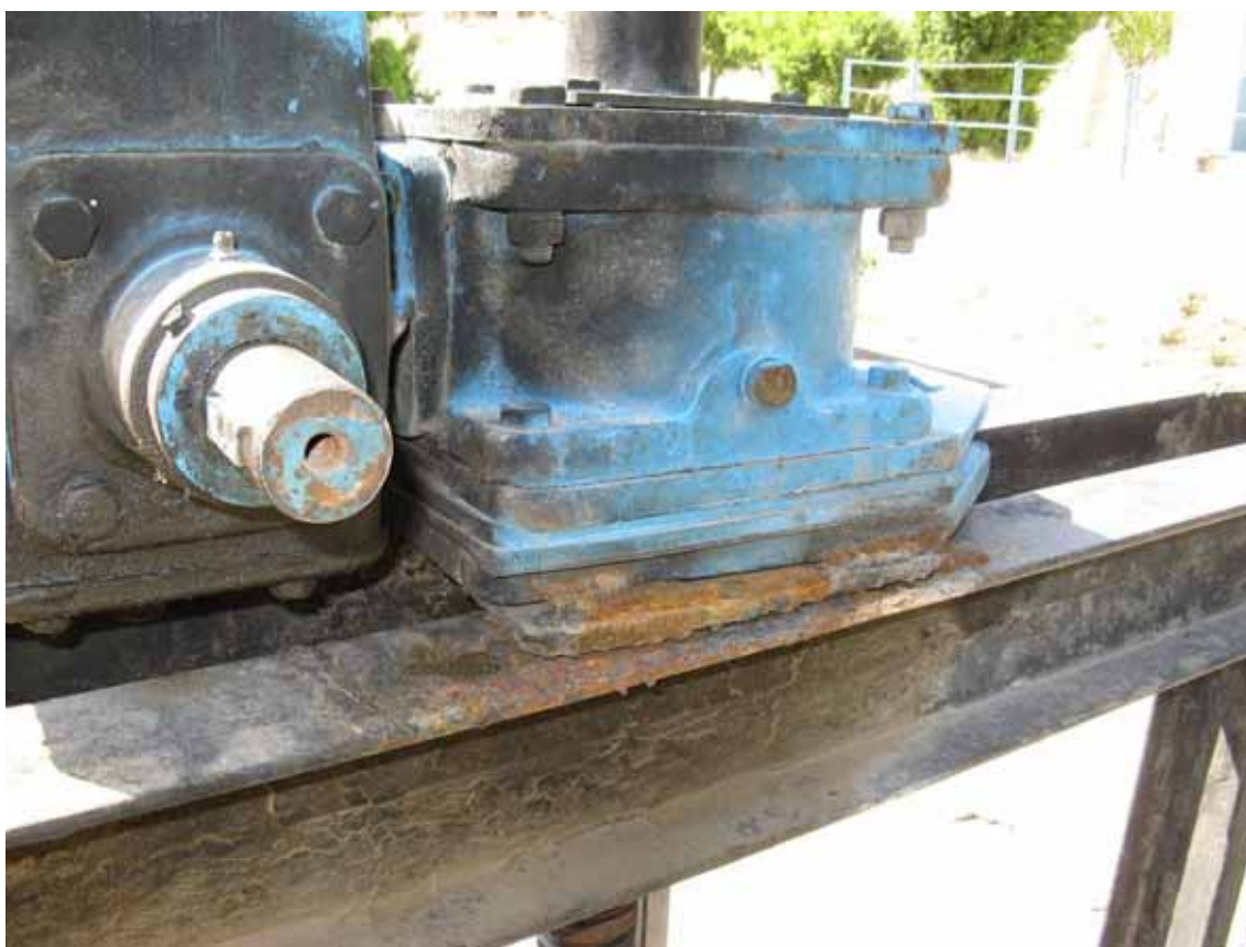
Поврежденная приварка редуктора в точке 2
