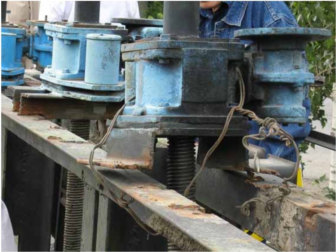
Поврежденная опора редуктора в точке б
