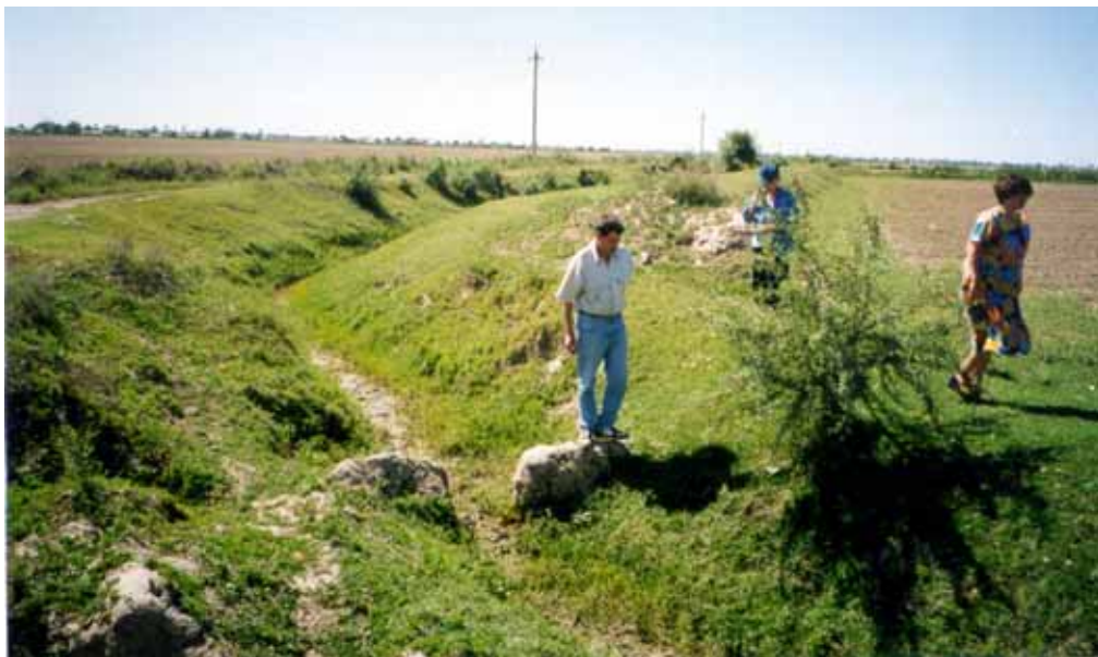
Внутрихозяйственные каналы и регулирующие сооружения в запущенном состоянии – Х-во 03, Южный Казахстан
