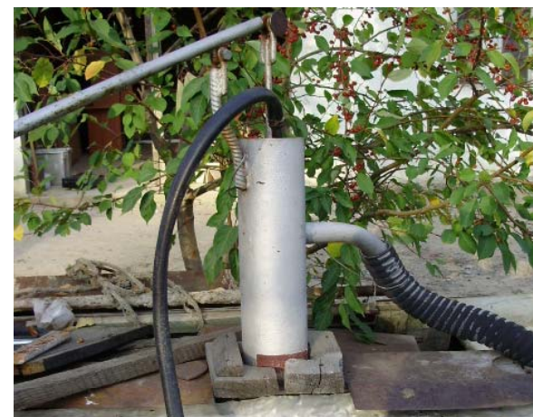
Скважина подземной воды №25 А
