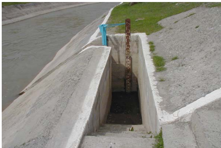
Рис.2. Успокоительный колодец с гидротехнической рейкой.
