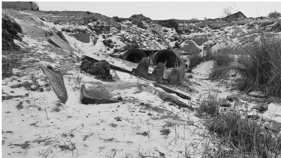
Рисунок 4 – Текущее техническое состояние сооружения в нижнем бьефе (фото В. Ф. Талалаева)
