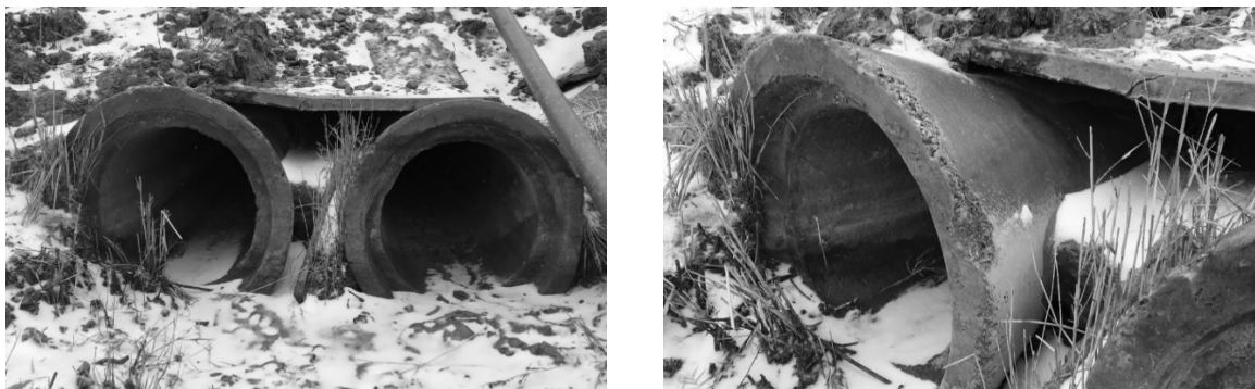
Рисунок 6 – Техническое состояние двухочкового трубчатого водовыдела в нижнем бьефе (фото В. Ф. Талалаева)
