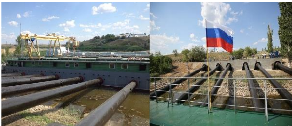
Рисунок 1 – Плавучие насосные станции в Быковском районе Волгоградской области, построенные по ФЦП «Развитие мелиорации земель сельскохозяйственного назначения России на 2014–2020 годы» (источник: www.volgograd.ru )
