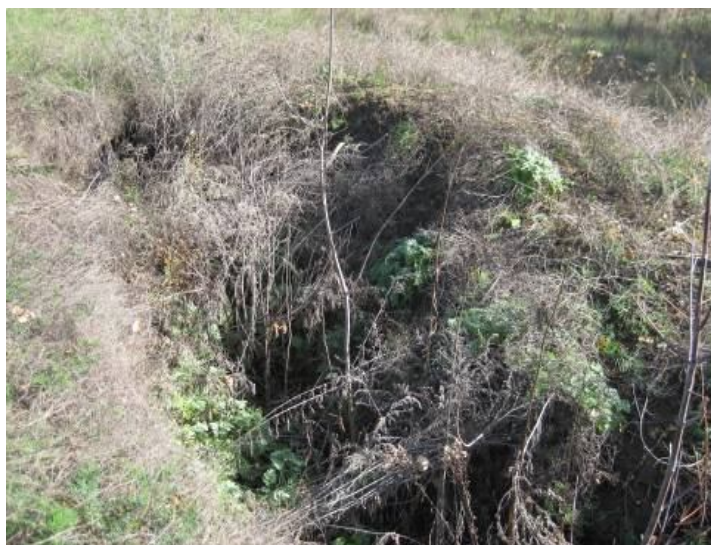
Рисунок 3 – Фильтрационные деформации в нижнем бьефе плотины (автор фото О. А. Баев)
