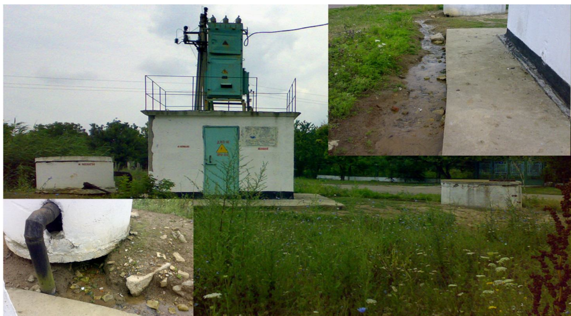
Рисунок 7 – Самоизливающаяся дренажная скважина дебитом до 15 м 3 /ч на дренажной насосной станции № 16 (ДНС 16)
