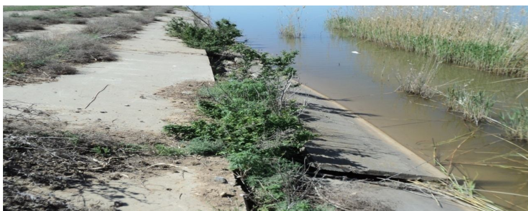
Рисунок 4 – Оползание плит по мокрому откосу
