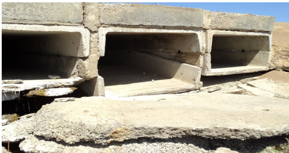
Рисунок 6 – Просевшая концевая часть водопроводящих труб
