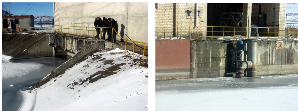
а) рыбозащитное устройство на входе в АПС; б) струевое РЗС
