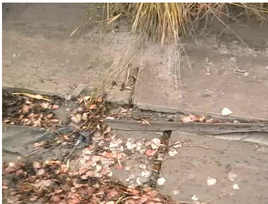
Рис. 2. Сползание плит НПК с полным повреждением полиэтиленового пленочного экрана на распределительном канале Багаевско-Садковской оросительной системы Ростовской области Бг-Р-7
