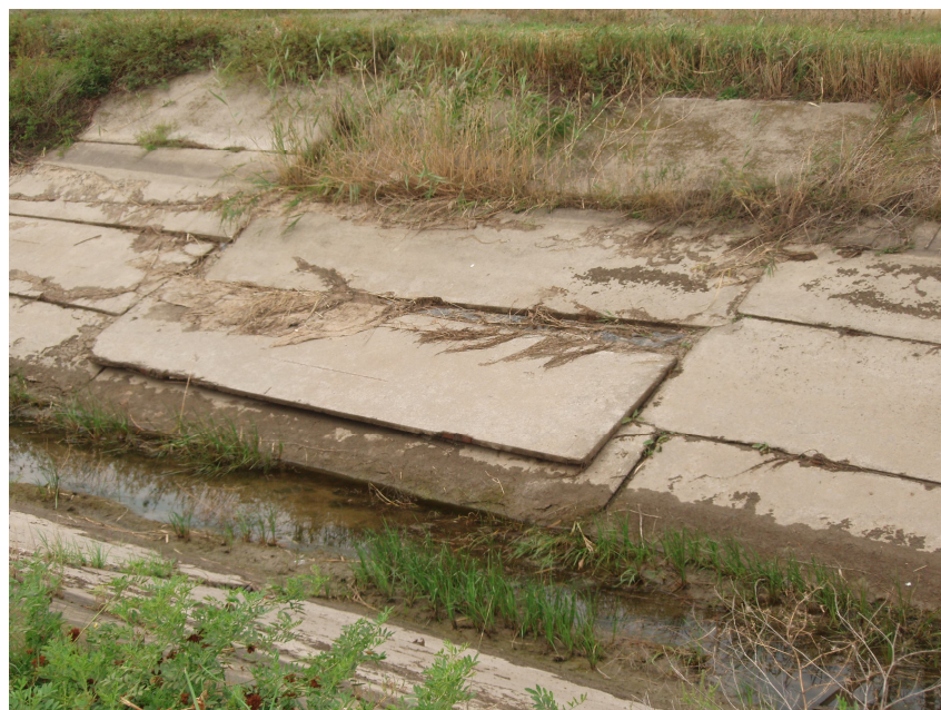
Рис. 3. Оползание плит и оголение противofильтрационного экрана на Нижне-Маньчском канале
