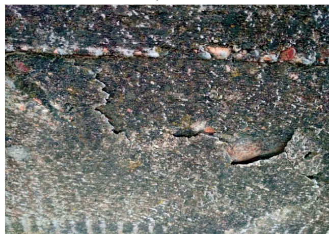
Рис.2. Разрушение защитного слоя бетона, правой части лотка, площадь разрушения 20х15 см
