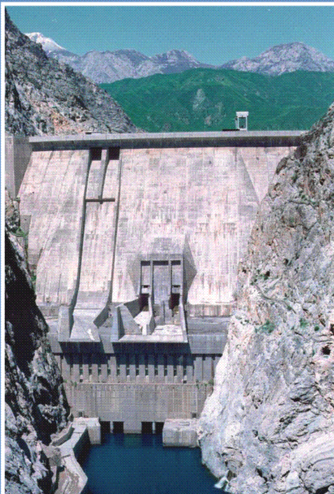
Рис. 7. Плотина Токтогульского гидроузла на реке Нарын, Казахстан (высота плотины - 215 м; объем водохранилища - 19500 млн.м 3 )
