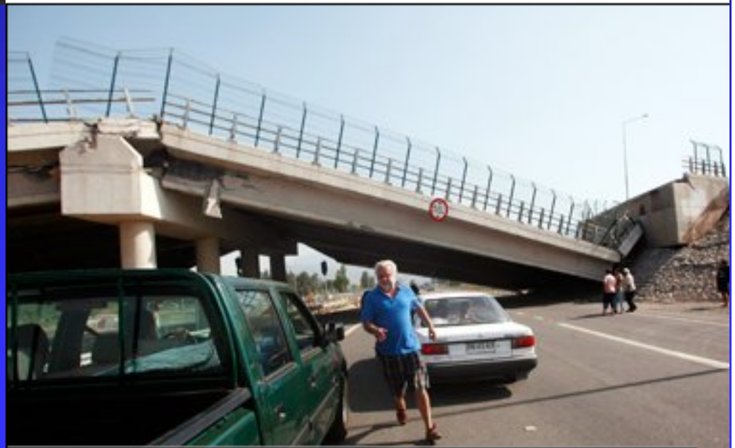
Подземная стихия разрушила мосты и дороги
